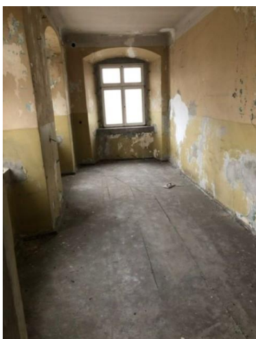
Fig. 5. Damp walls (photo J. Markowska)
